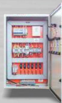
Painéis de comando
